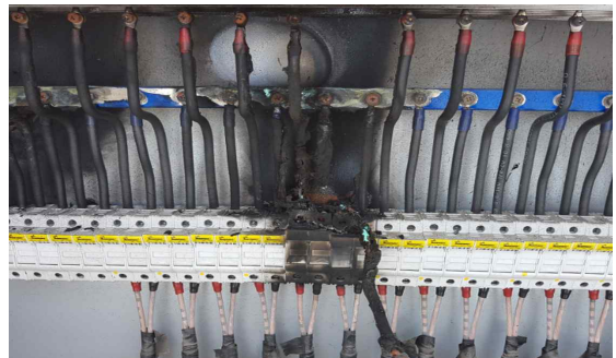
그림 1 접촉불량으로 인한 DC 접속반 화재 Fig. 1 DC connection panel fire due to Contact Badness Faults
