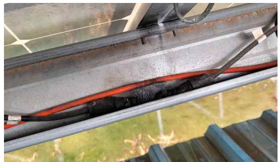
그림 2 직렬아크로 인한 DC 선로 소손 Fig. 2 DC Line damage due to series arc
