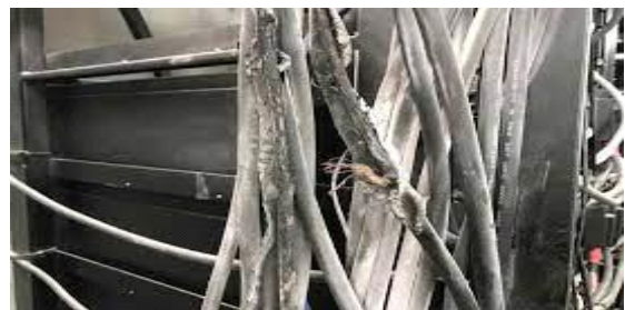
그림 2. 케이블 손상에 의한 ESS 화재 Fig. 2 ESS fire due to cable damage
