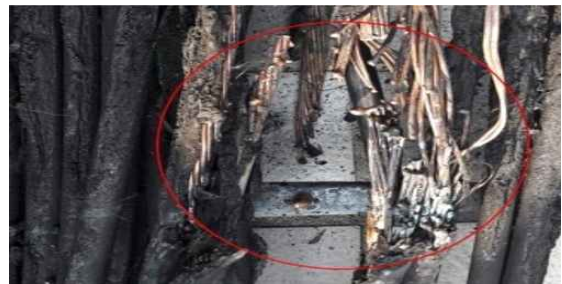
그림 1. 케이블 손상에 의한 DC 접속반 화재 Fig. 1 DC connection panel fire due to cable damage
