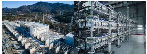
그림 2. 200MW HVDC 실증단지 전경 및 컨버터 밸브
